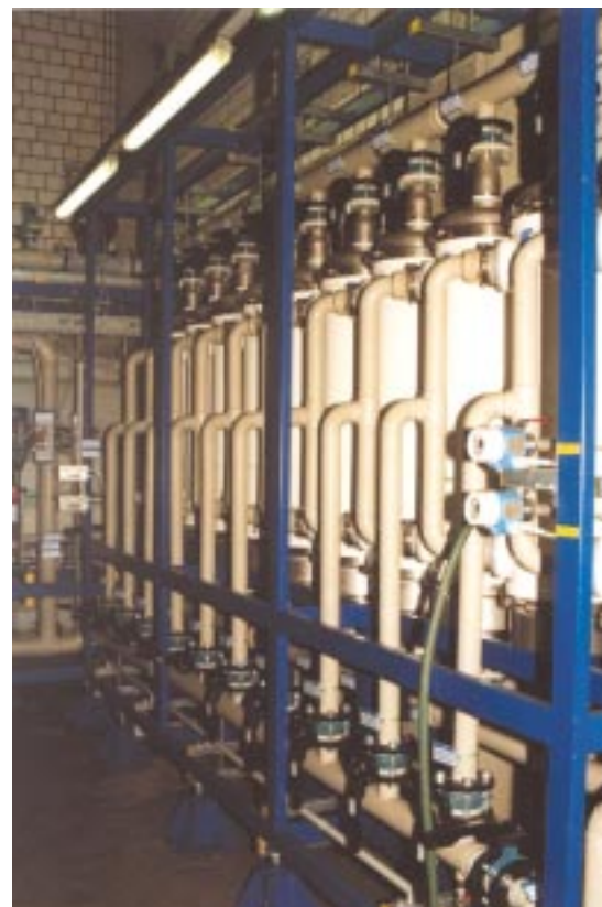
Bild 3: Ultrafiltrationsanlage des Heizwerkes der envia in Guben
